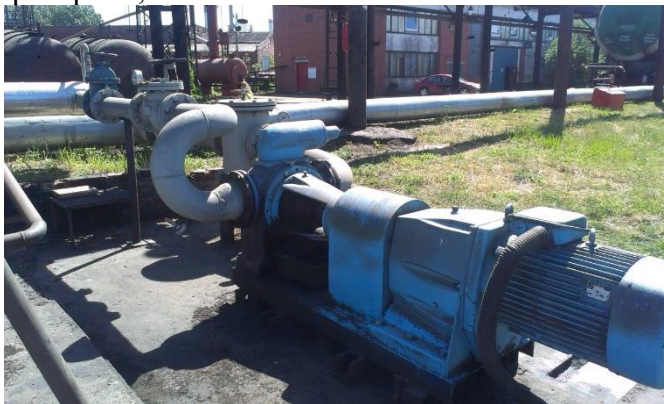
7.attēls. Sūkņu stacija S1 (pie dzelzceļa estakādes)
