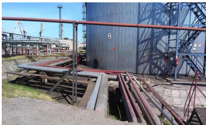
9.attēls. Cauruļvadu sistēma rezervuāru parkā
