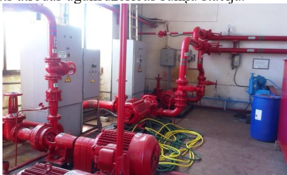
13.attēls. Ugunsdzēsības sūkņu stacija
