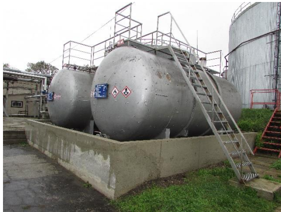
14.attēls. Horizontālie cilindriskie rezervuāri HTR 30 dzelzsbetona apvalņojumā
