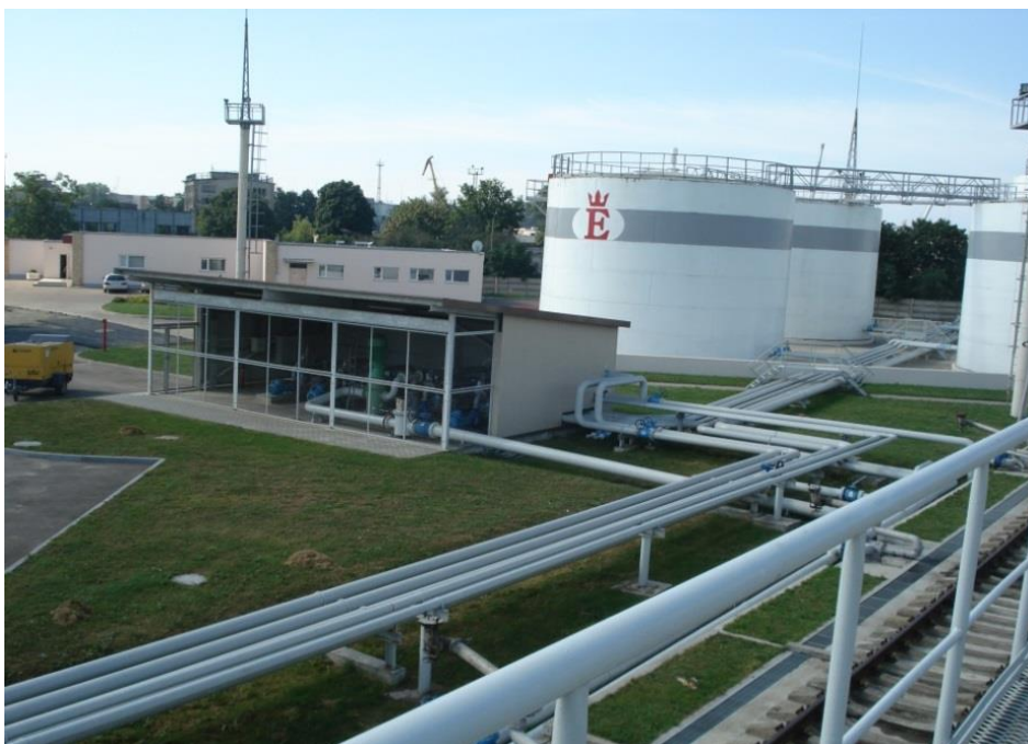
9.attēls. Sūkņu stacija Nr.1 ar cauruļvadu sistēmu
