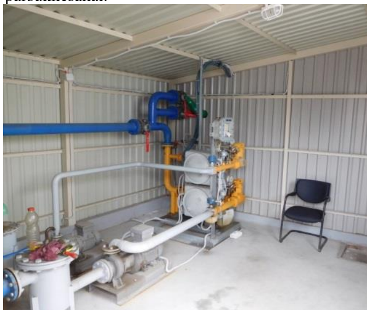
13.attēls. Sūknis G60-100 sūkņu stacijā Nr.3
