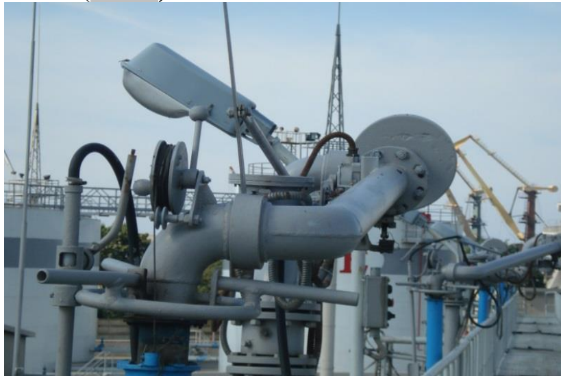
7.attēls. Noliešanas posteņi ar noliešanas armatūru
