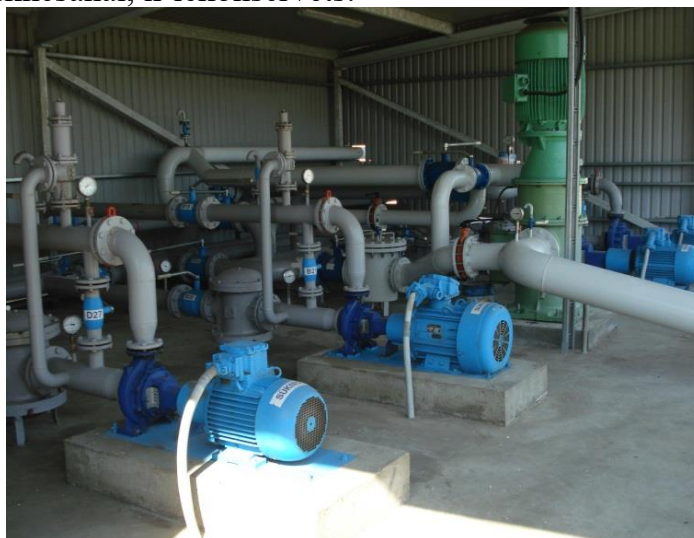
10.attēls. Sūkņi sūkņu stacijā Nr.1
