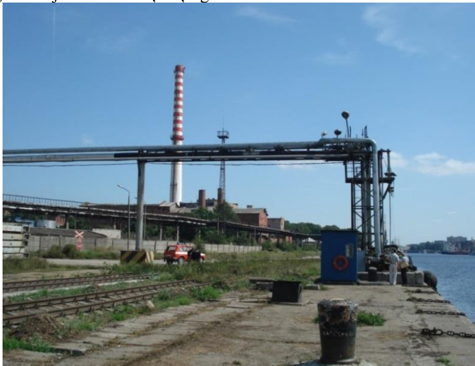
20.attēls. Tankkuģu piestātne Nr.68 ar 2 cauruļvadiem naftas produktu pārsūkņēšanai
