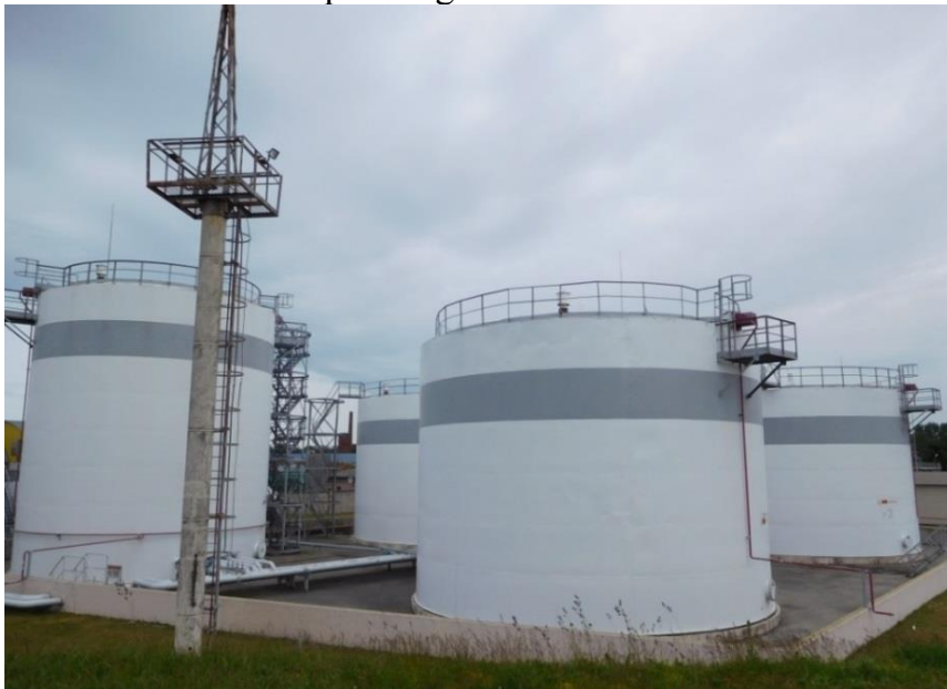
2.attēls. Virszemes rezervuāru parka pirmās grupas rezervuāri
