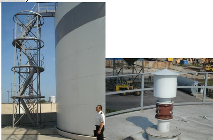
5.attēls. Kāpnes ar norobežojumiem un elpošanas vārsts uz rezervuāra jumta
