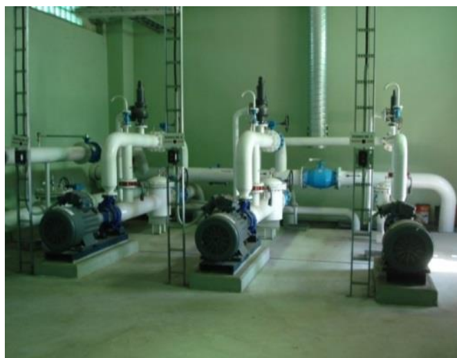
11.attēls. Trīs skrūves sūkņi ETANORM sūkņu stacijā Nr.2
