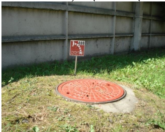
25.attēls. Aka ūdens ņemšanai ugunsdzēsības vajadzībām
