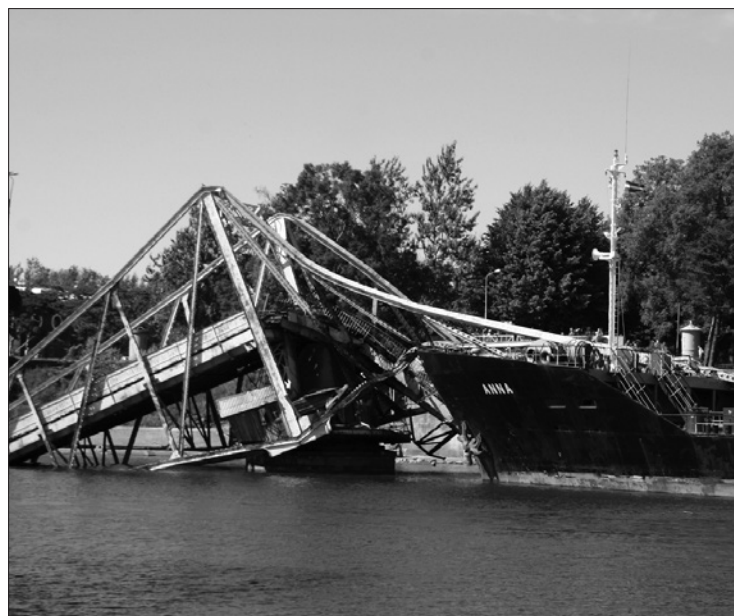
O. Kalpaka tilts pēc negadījuma 2006. gada jūlijā, kad tankkuģis “Anna” ieskrēja tilta ziemeļu daļā, tika neatgriezeniski bojāts, un bija nepieciešami četri gadi, lai Karostu atkal savienotu ar pārējo pilsētu.
